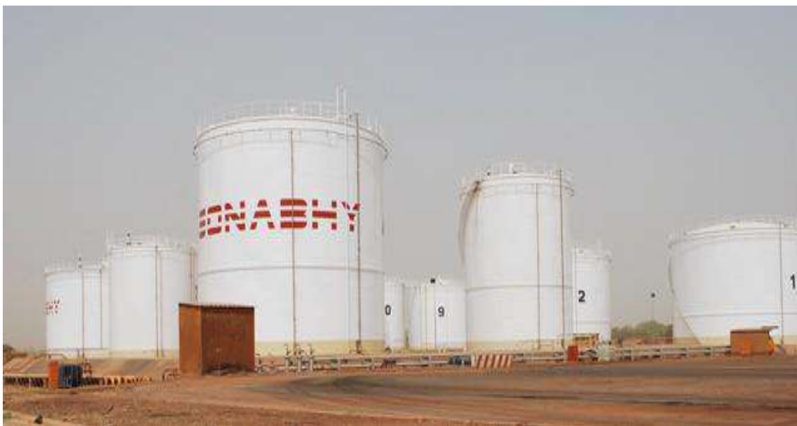
Photo 6: Vue d'ensemble des 10 réservoirs HL du dépôt de Bingo
