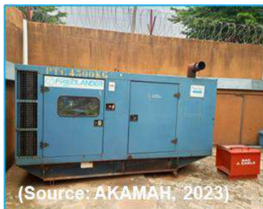
Photo 1: Groupe électrogène à gazole
